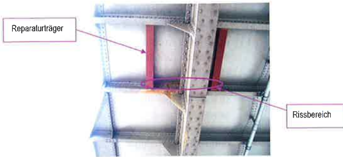
5 Riss am Querträgeranschluss © Eiffel Deutschland Stahltechnologie GmbH
