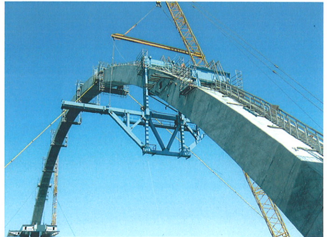
Bild 11. Am Bogen abgehängte Auflager- Fachwerkscheibe Fig. 11. Supporting framework, hanging from the concrete arch
