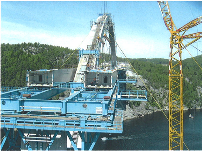
Bild 13. Hilfsbrücke als temporäres Auflager bei der Hubmontage Fig. 13. Small steel bridge, working as auxiliary support for lifted sections
