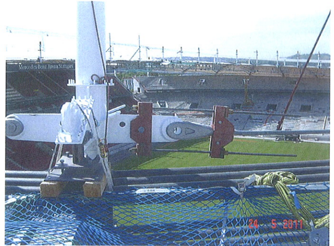
Bild 10. Temporärer Anschluss des unteren Ringseils an eine Luftstütze Fig. 10. Temporary connection between a lower ring cable and a column
